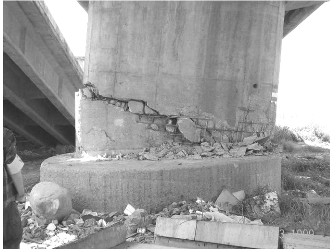
圖 4.22 921 集集大地震之烏溪橋橋柱剪力破壞
