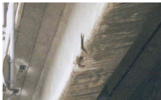
圖 4.7 跨越橋之大梁為超高車輛撞損，鋼筋外露
