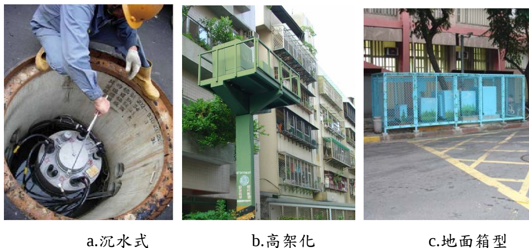
圖 3.100 目前電力系統控制箱擺設方式
