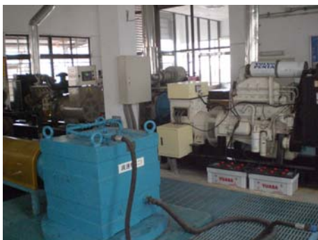
抽水機組及發電機組（正面）
