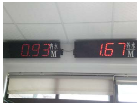
內外水位監控設施
