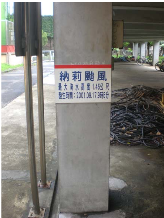
圖 4-48 納利颱風導致散熱系統及 機電設備癱瘓
