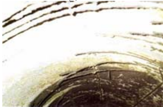
(d) Spalling large
