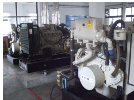
抽水機組及發電機組（背面）
