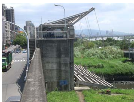
出水閘門（側面）
