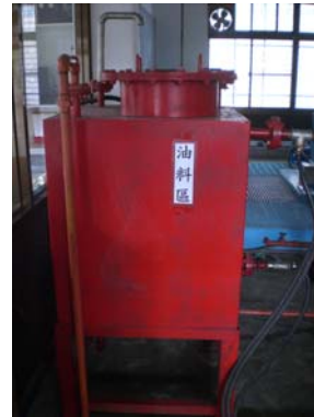
內部儲油設施
