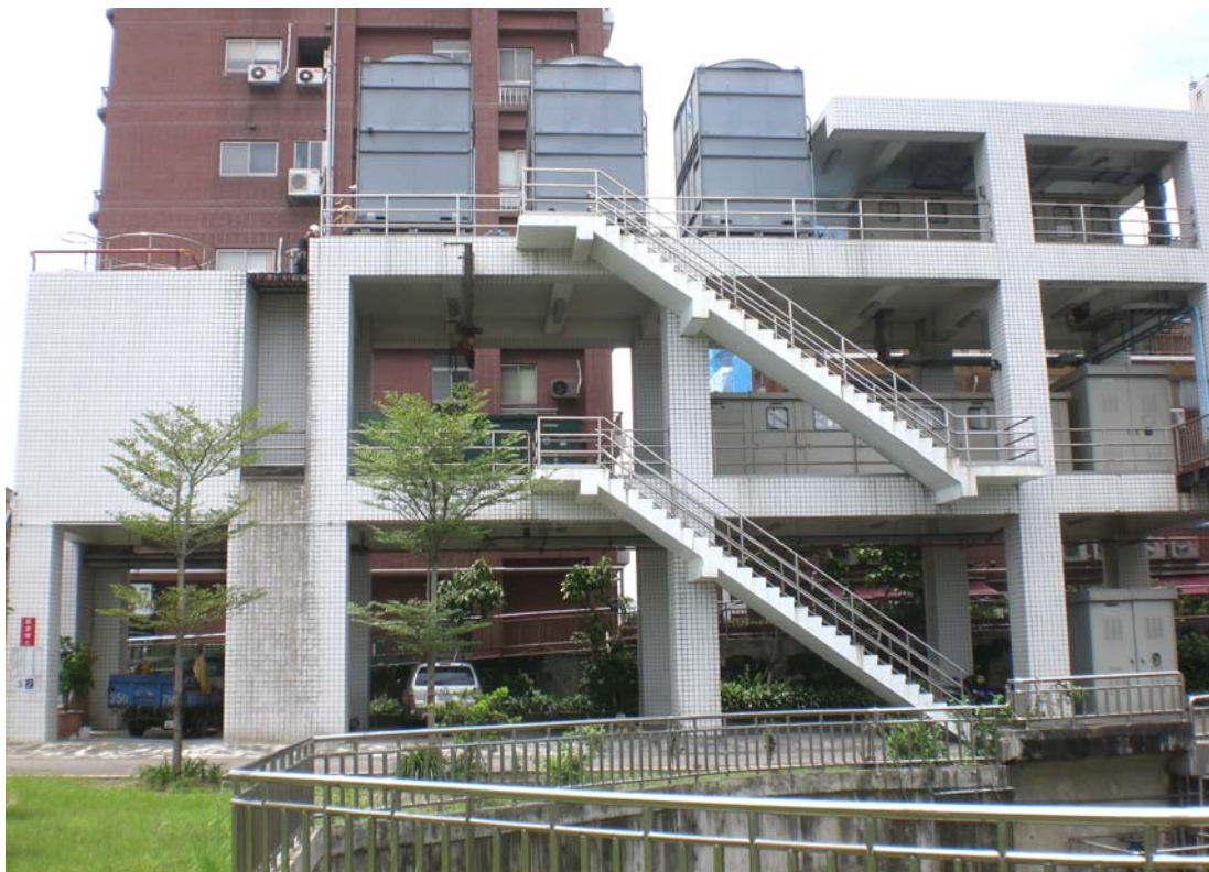
圖 4-51 南港抽水站架高機電設備、散熱系統、貯油槽等設施
