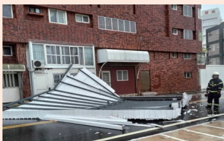
公寓頂樓鐵皮屋遭強風吹落，影響通行
