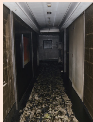
大樓內部 走廊煙燻情形
