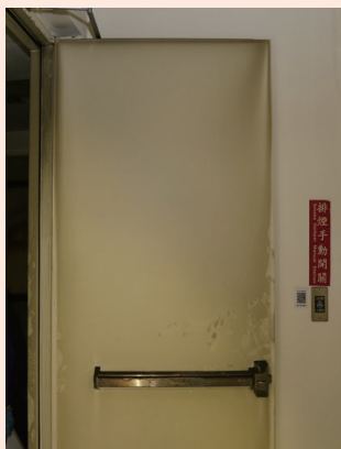
安全梯間防火門未關閉 導致濃煙進入梯間
