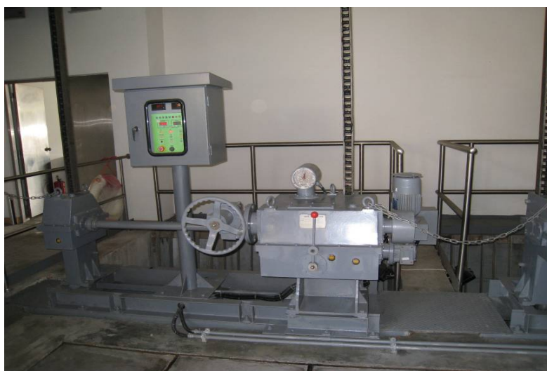
圖 5 12CMS 抽水機內池維修閘門操作設施
