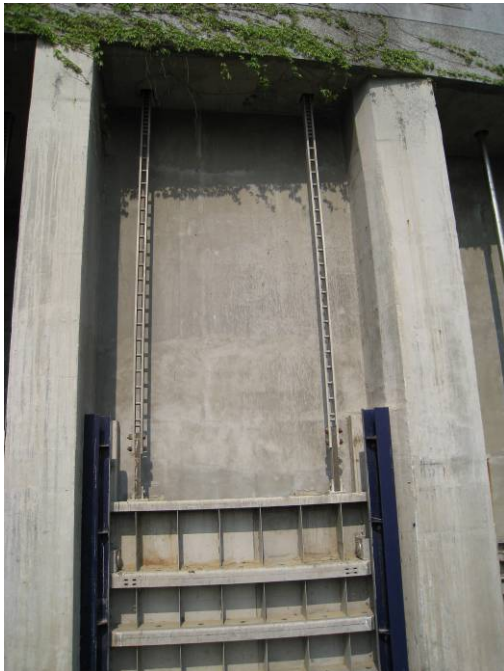
圖 16 12CMS 抽水機閘門
