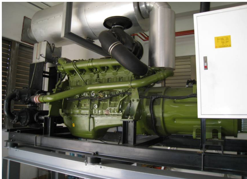
圖 1 中港抽水站發電機
