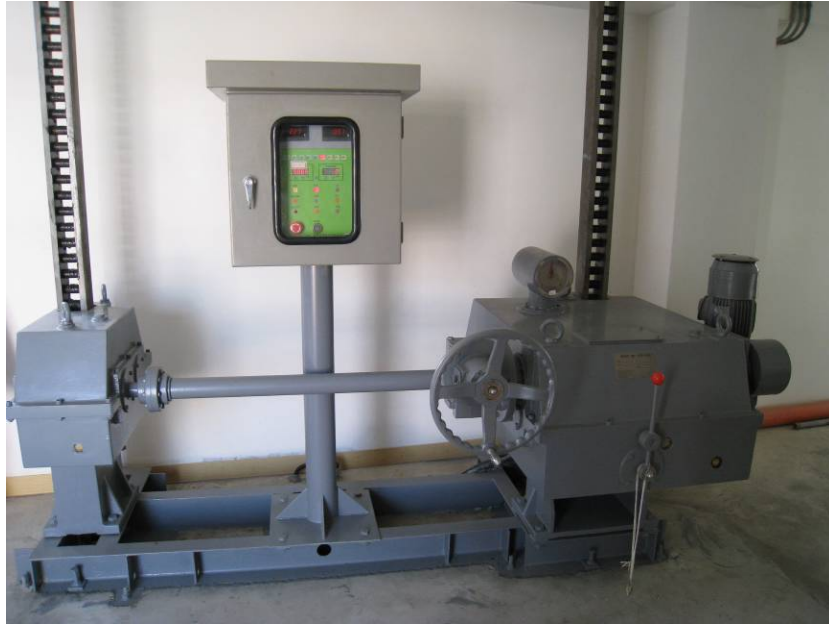
圖 10 12CMS 抽水機外池維修閘門操作設施
