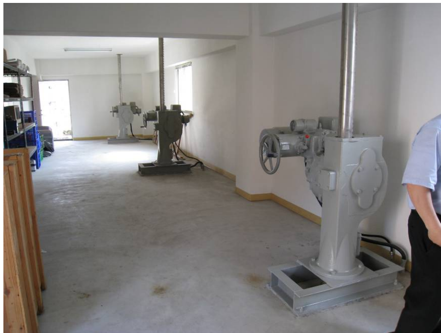
圖 9 5CMS 抽水機外池維修閘門操作設施
