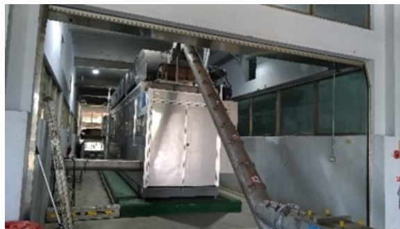
圖 2 斗六廠污泥乾燥設備
