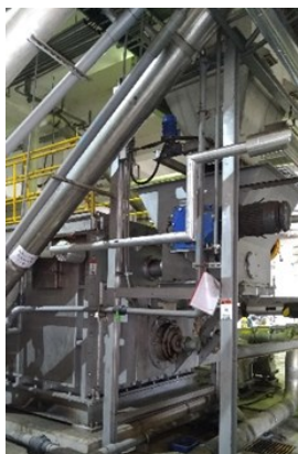
圖 1 福田廠污泥乾燥設備
