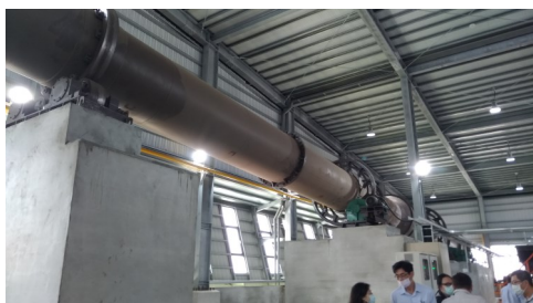
圖 6 仁德廠下水污泥再利用設備-旋轉窯
