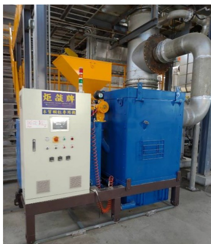
圖 4 宜蘭廠下水污泥再利用設備-炭化爐
