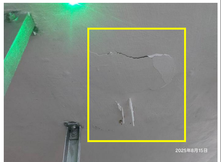
照片 10:所指地下室兩人孔間脫漆及滲水
