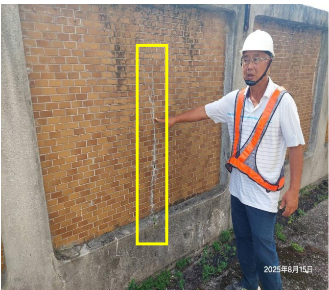
照片 5:所指圍牆內一道垂直裂痕(4 處)
