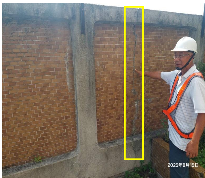
照片 4:所指圍牆內一道垂直裂痕(3 處)
