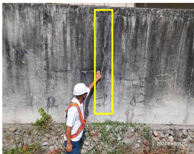
照片 1:所指圍牆外一道垂直裂痕(1 處)
