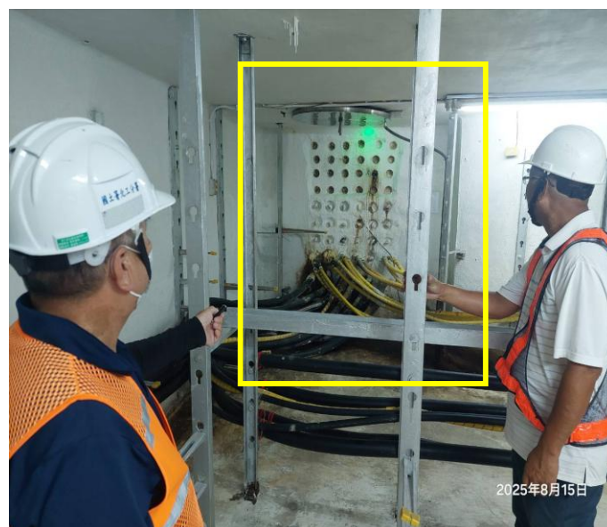
照片 6:所指地下室右側滲水情形(1 處)
