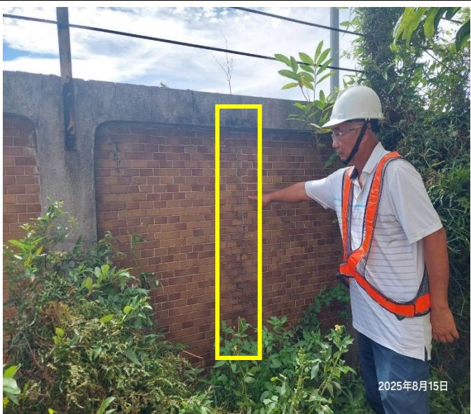
照片 3:所指圍牆內一道垂直裂痕(2 處)
