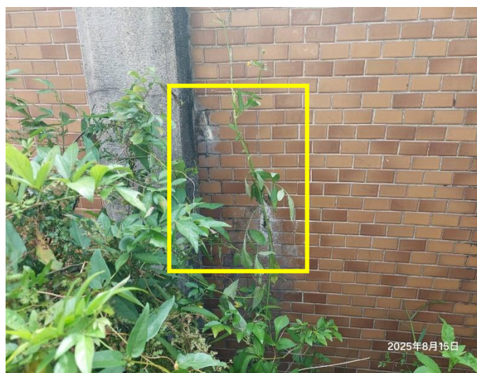
照片 2:所指圍牆內一道垂直裂痕(1 處)
