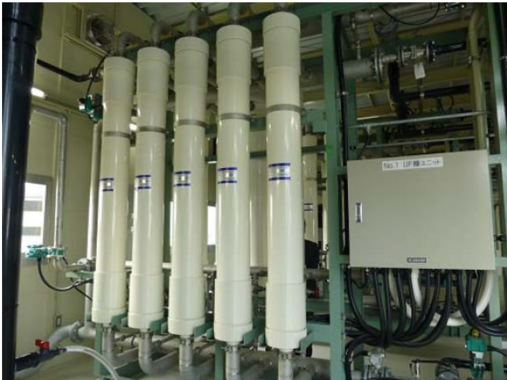
圖 2-5 UF 膜過濾裝置（實證設施）的外觀
