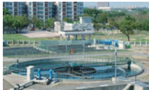
▲鳳山溪污水處理廠二沉池
