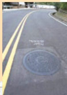
▲明德污水系統人孔蓋
