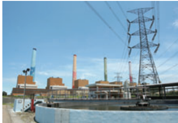
▲關連污水處理廠二沉池
