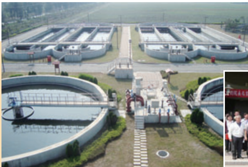
▲二林污水處理廠氧化渠及二沉池
