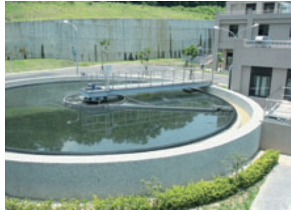
▲竹東水資源回收中心二沉池
