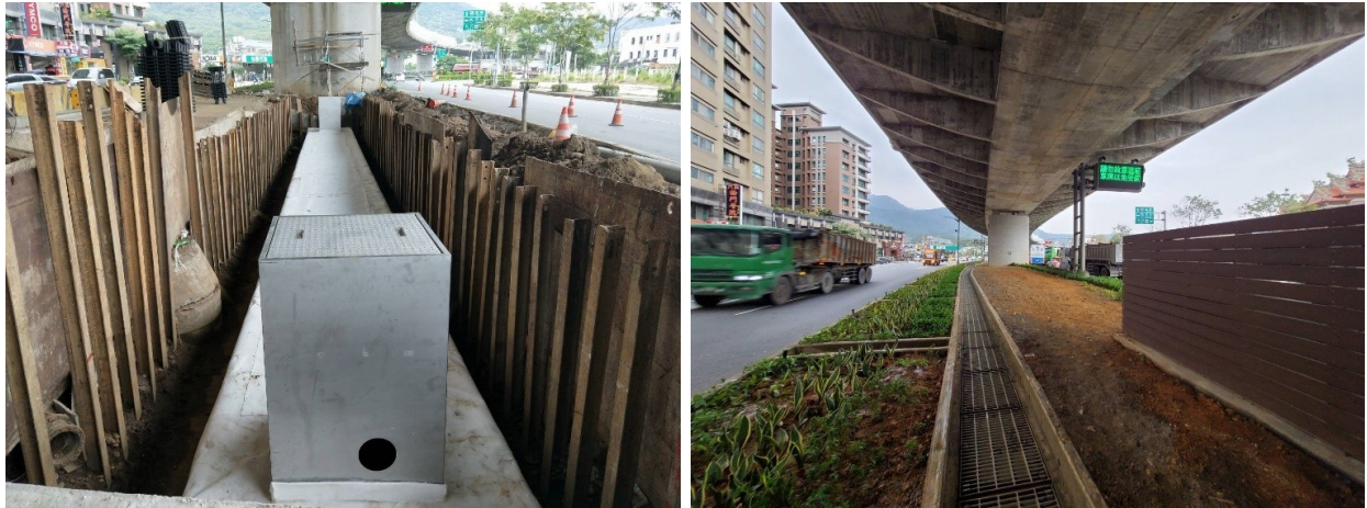
圖 12 高架橋梁下方貯留設施 ( 築綠生態提供 )
