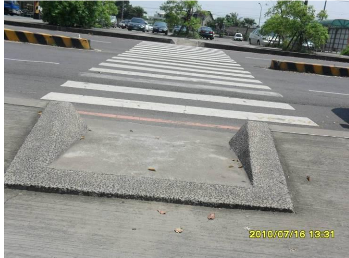
圖3-19 地點：彰化縣員林鎮簡易法庭側邊道路 說明：斜坡道未平順銜接至車道，影響行人通行安全
