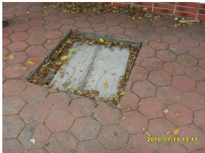
圖3-16 地點：南投縣草屯鎮仁愛街 說明：排水溝須加設水溝蓋
