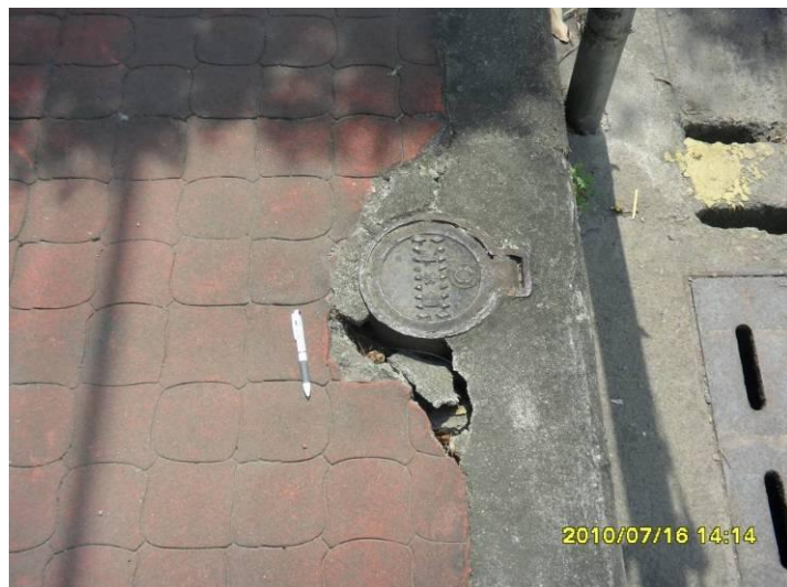
圖3-20 地點：彰化縣員林鎮靜修路 說明：人行道有坑洞，影響行人通行安全
