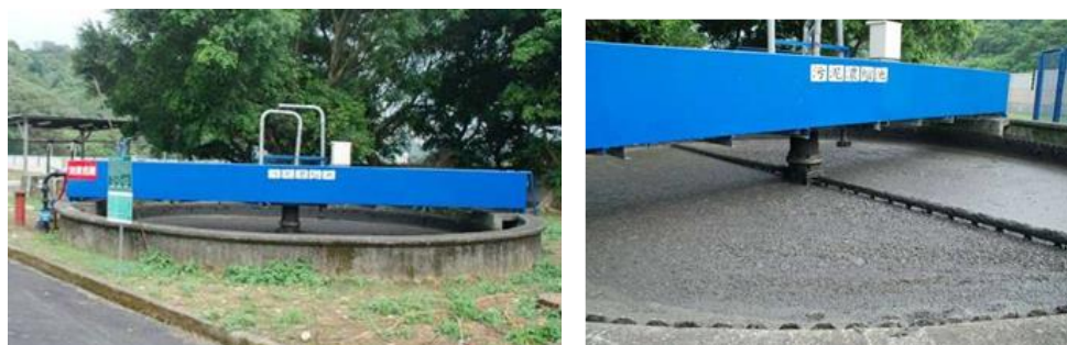
圖 10.8 重力濃縮槽(龜山水資源回收中心)
