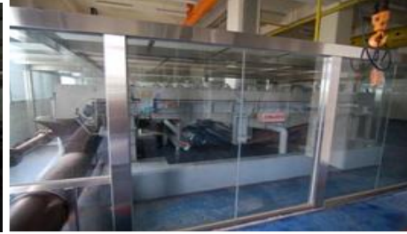
濃縮機外圍設置玻璃防臭罩
