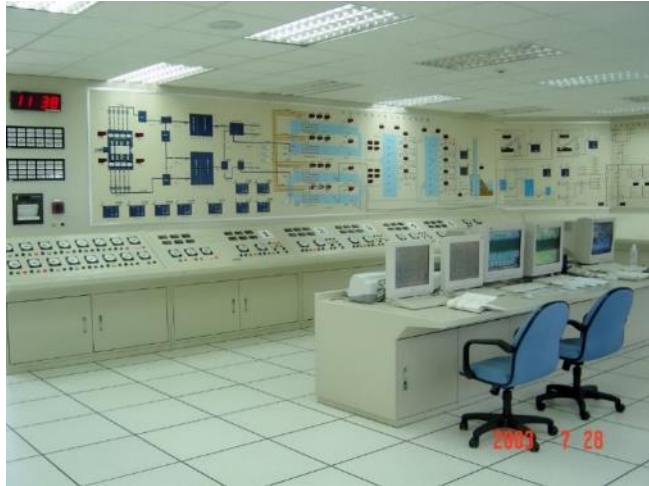
圖12.15 中央監控中心監控設備配置實景圖之一
