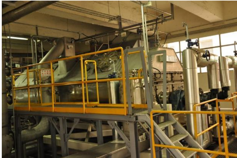
圖 10.68 污泥乾燥機例(迪化污水廠)
