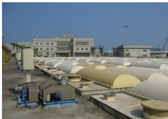
圖 6.7 初級沉澱池的防臭蓋板 (基隆和平島污水處理廠)
