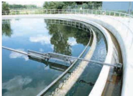
圖 6.18 周邊進水式沉澱池照片
