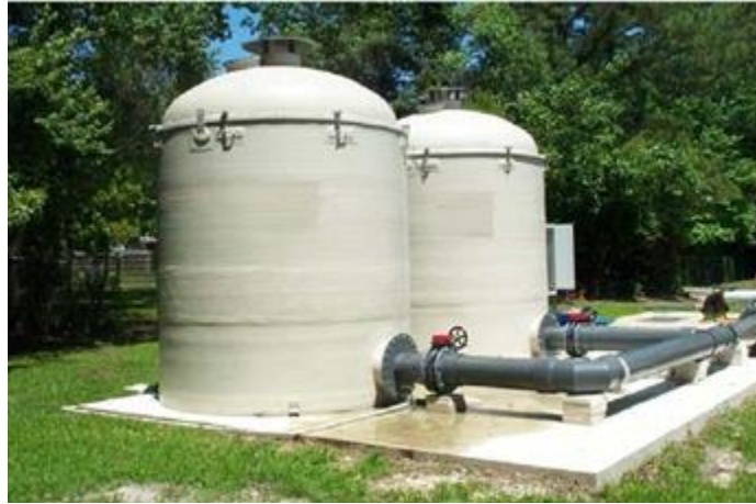
圖 11.7 除臭用生物洗滌塔照片
