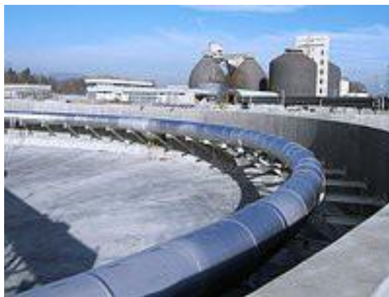
圖 6.28 圓形池之出水管照片
