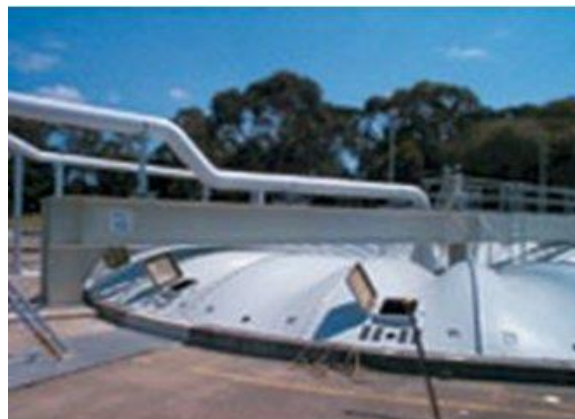
圖 6.8 圓形初級沉澱池加防臭蓋板 (澳洲 Subiaco 污水處理廠)
