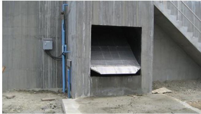
圖 6.23 高雄市楠梓水資源回收中心斜板細篩機
