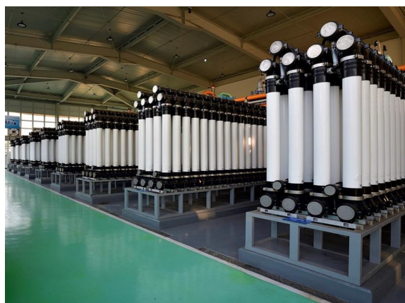
圖 7 鳳山水資中心的超微過濾單元
