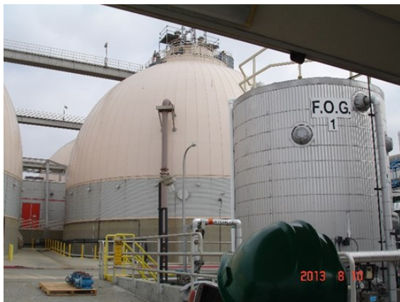
圖 5 Hyperion 污水處理廠蛋形消化槽（FOG 為餐廳廚餘之攪拌槽）
