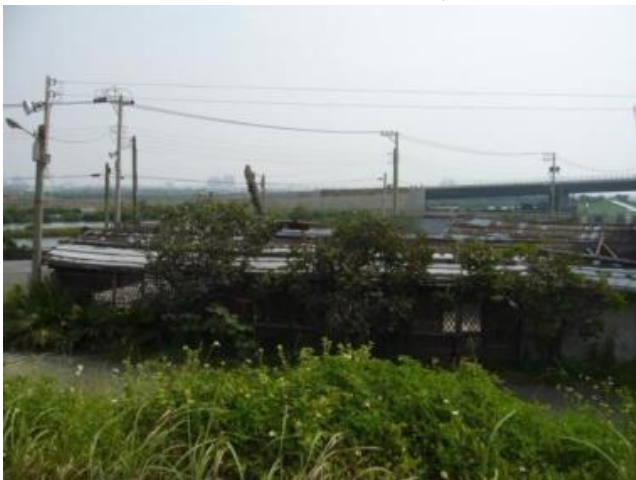
(a) 地層下陷：電線桿歪斜，結構沉陷
