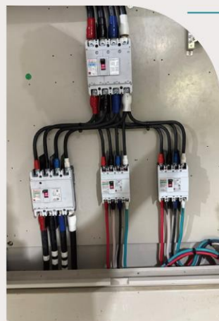
幹線漏電斷路器
