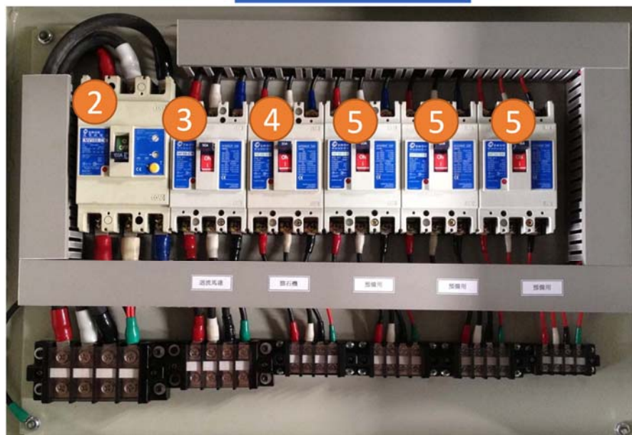
2 總電源，漏電斷路器(黃色按鈕)
