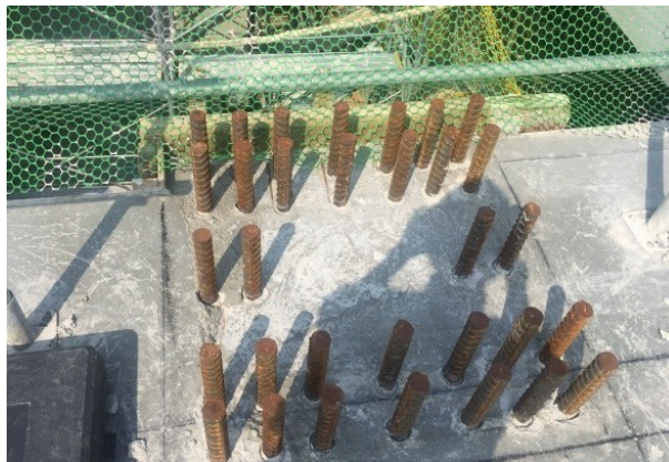
圖 R9.3 預鑄特殊結構牆工法之接合用金屬配件及預鑄特殊抗彎矩構架工法之接合用鋼筋
