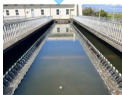
廢水處理設施
