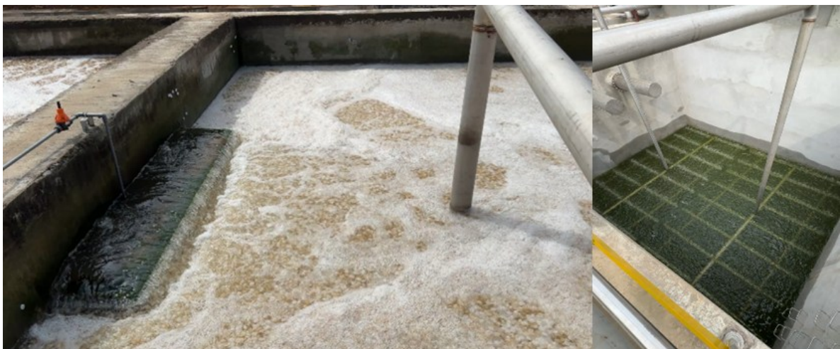
圖 4 本案現場 MBBR（好氧/硝化池）移動床生物膜反應器及曝氣裝置
