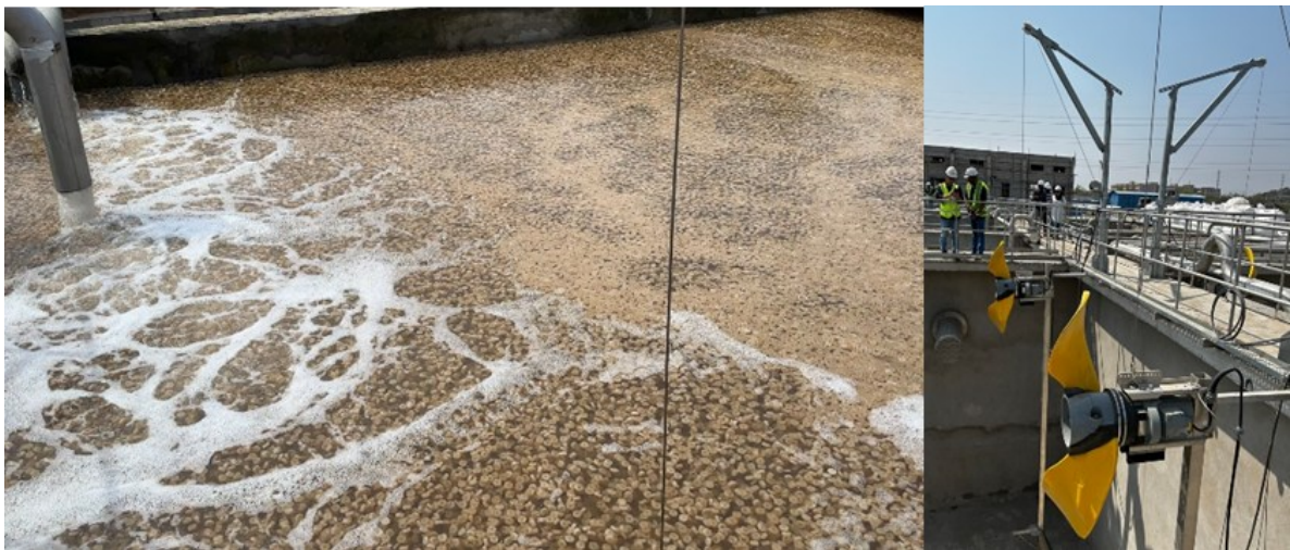
圖 3 本案現場 MBBR（脫硝池）移動床生物膜反應器及攪拌設備
