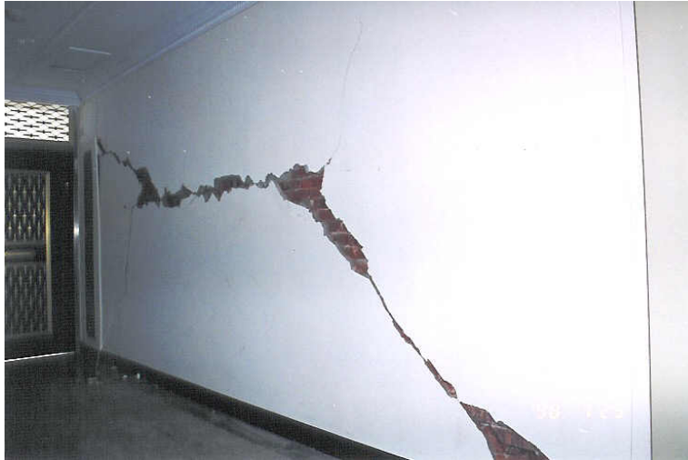
圖 RA.7 (a) 磚牆對角線角度小於臨界破裂角之破壞照片
