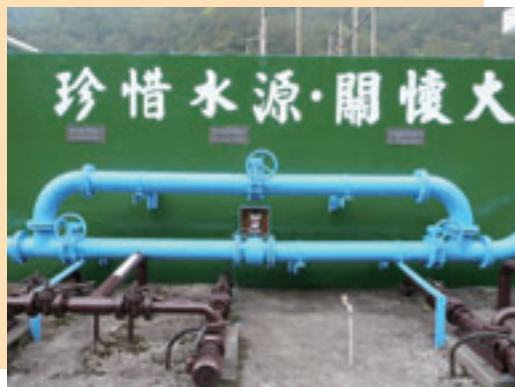
▲烏來污水處理廠終沉池污泥泵
