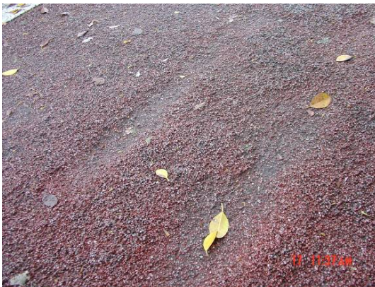
(e) 透水性混凝土表面車轍情況
