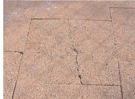
B 型透水鋪面龜裂狀況
