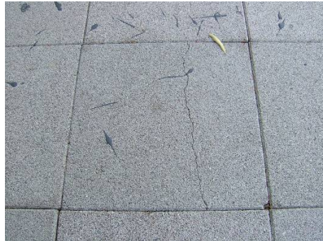
A 型透水鋪面堵塞狀況
