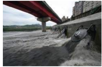
圖 4.14 抽水站運作情形
