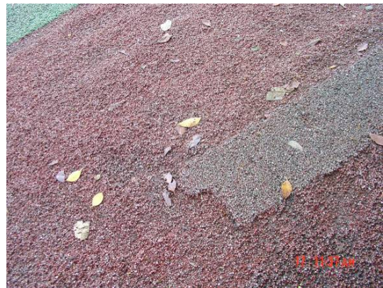
(f) 透水性混凝土剝落
