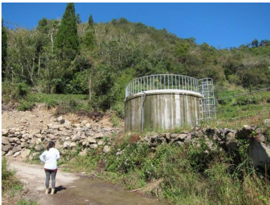
水塔為家戶重要生活設施
