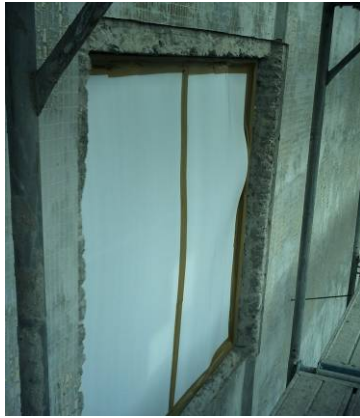
▲整建中磁磚鼓起及窗框周沿打除
