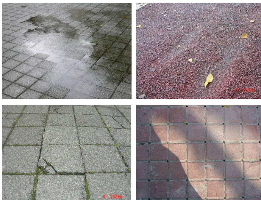
圖 2.51 透水性鋪面面磚損壞情形
