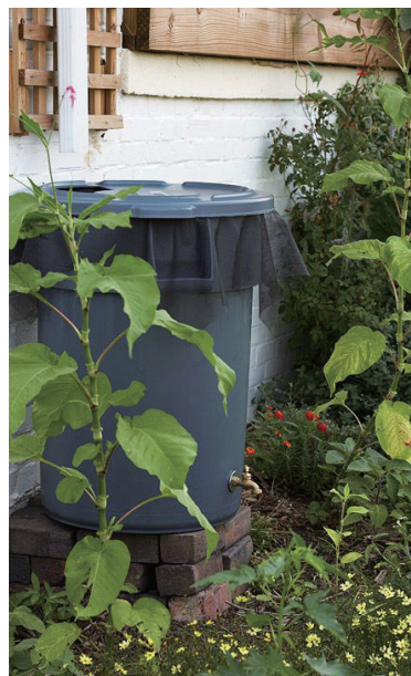
落水管出口在雨水桶外部上方
