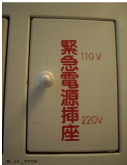
緊急供電設備
