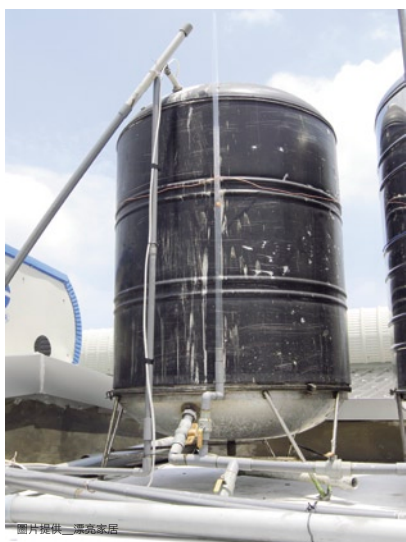
圖片提供__漂亮家居 將自來水塔漆成黑色，吸收更多的熱到水塔內，可減少太陽能熱水氣加熱的能源。
