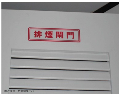
圖片提供__台灣建築中心 住辦大樓室內緊急排煙閘門
