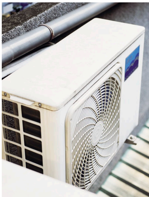
冷氣室外機散熱片應定期清洗以提高效率。
