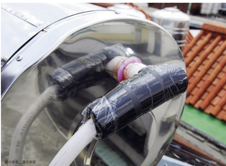
圖片提供__漂亮家居 熱水管必須有保溫層級外覆材包裹，減少熱耗損。
