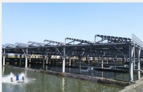
(地面型)太陽光電 非建築 設施比： 40%
