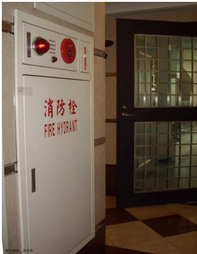
圖片提供_麥浩斯 室內消防栓箱
