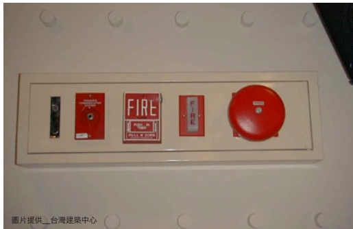
火警綜合盤安裝完成照片示意圖
