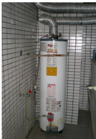
瓦斯熱水器放置於陽台通風處，並裝置排煙管，且為避免地震傾倒，可使用鐵鍊固定於牆面或地上，以維居家安全。
