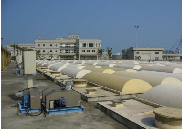
圖 4.8 初級沉澱池的防臭蓋 (基隆和平島污水處理廠)
