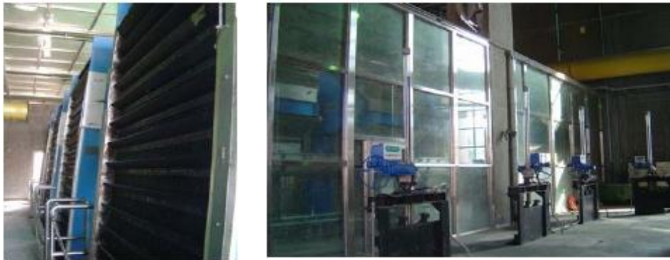
b. 攔污柵外圍設置透明防臭罩照片(台北市內湖污水處理廠例)
