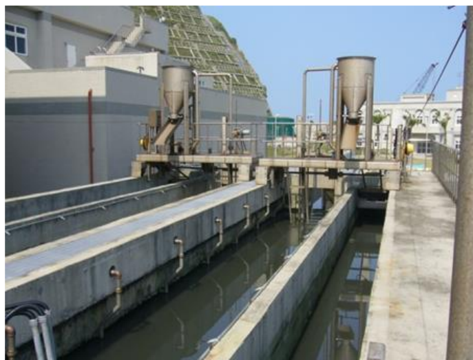
圖 3.91 曝氣沉砂除油池(基隆市和平島水資源回收中心)
