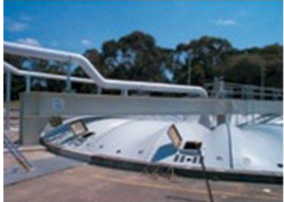
圖 4.9 圓形初級沉澱池加防臭蓋 (澳洲 Subiaco 污水處理廠)
