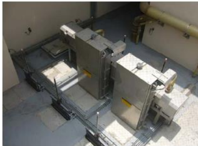
c. 包覆式攔污柵及輸送機照片(新竹市客雅水資源回收中心例)
