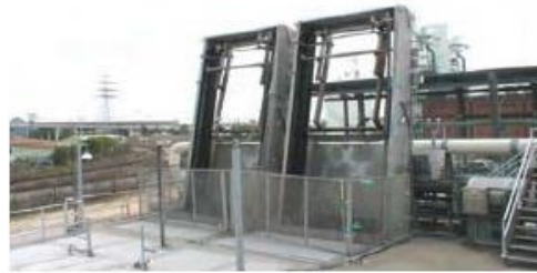
b.實際安裝照片
