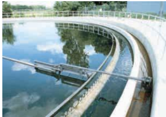
圖 4.18 周邊進水式沉澱池照片
