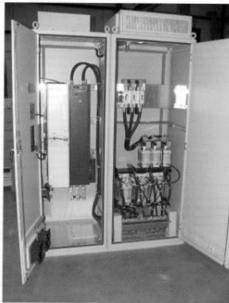
圖 3.69 300 hp 電動機變頻器照片
