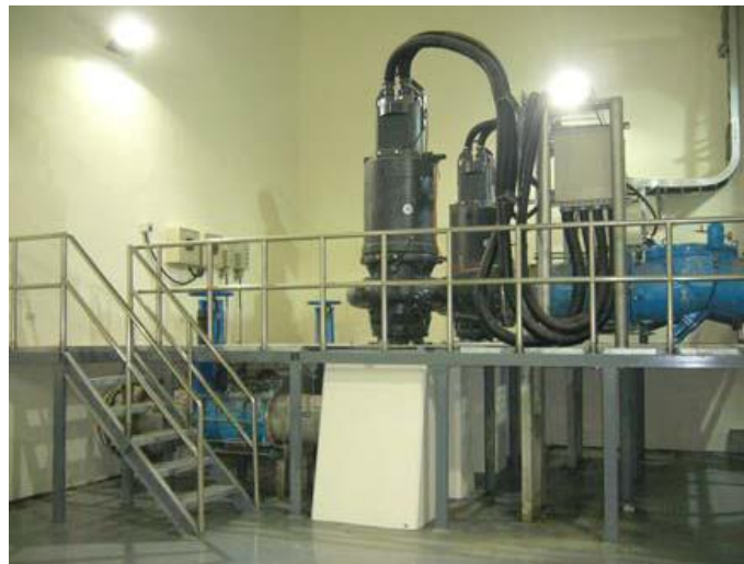
圖 3.68 進流抽水站乾井使用沉水式抽水機的相片 (新竹客雅水資源回收中心例)
