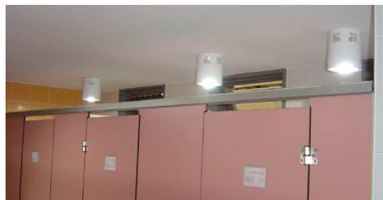
圖 3-12 廁間之照明裝置
