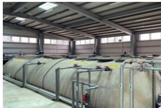
MBR 污水處理系統
