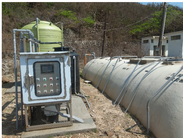
東吉嶼入口意象之汙水處理設施
