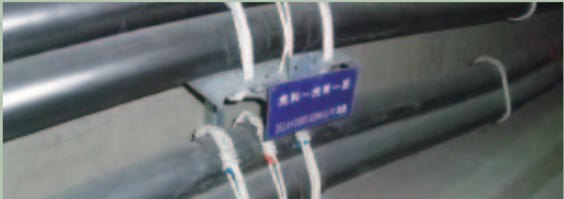
◆ 共同管道纜線標示
