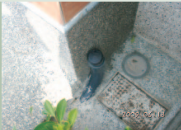
◆ 寬頻管道引上管
