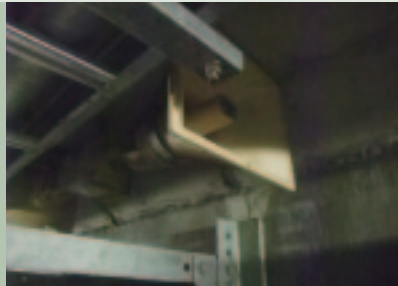
◆ 共同管道廣播設備
