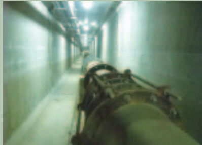
◆ 自來水管道（臺南市）
