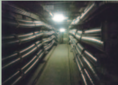
◆ 電力管道（臺北市）
