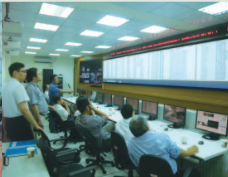
◆ 共同管道監控中心（臺北市）
