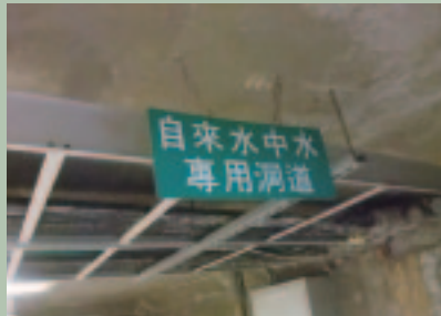
◆ 共同管道指示吊牌
