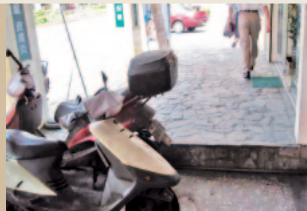
◆各縣市現況調查高差及鋪面破損照片（以臺北縣為例）
